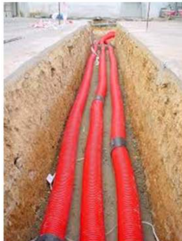
Daños en redes eléctricas
