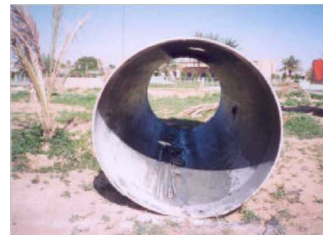
Tubería DN1800 GRP después de 25 años de servicio
